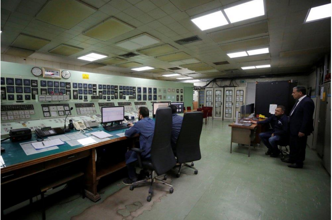
Keban Barajının enerji üretimi kumanda odası.
