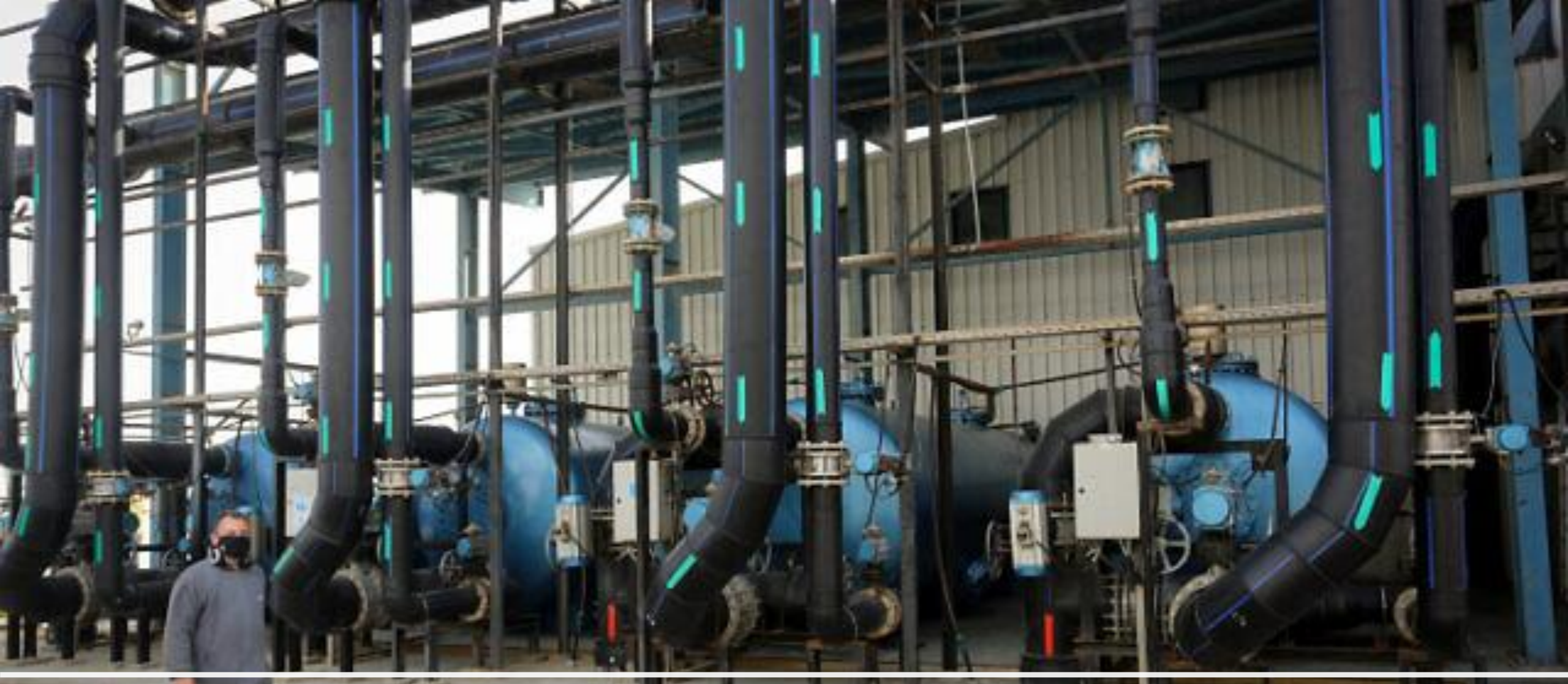
Denizsuyu Arıtma Tesisi
