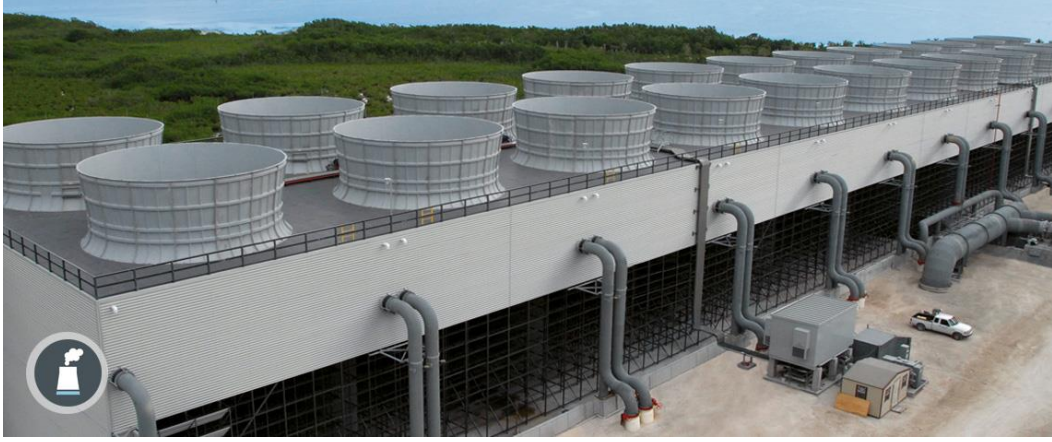
Şekil 15 b. Kuru soğutma sistemi
