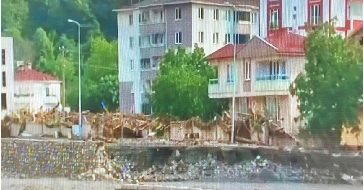
Bozkurt'ta tahrip olan nehir yatağı islah duvarı
