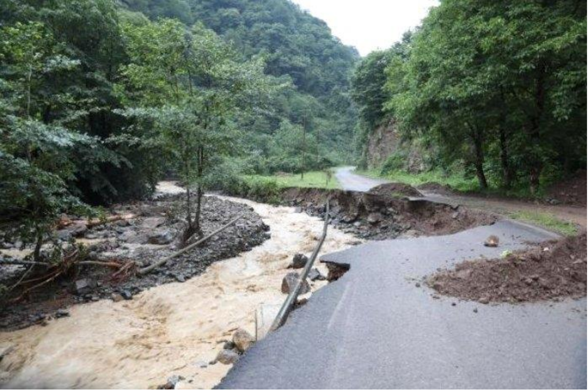
Foto 6 Taşkın debisinin yatay bir kurbda yaptığı tahribat
